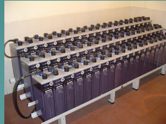
Banco de baterías 125 V DC
