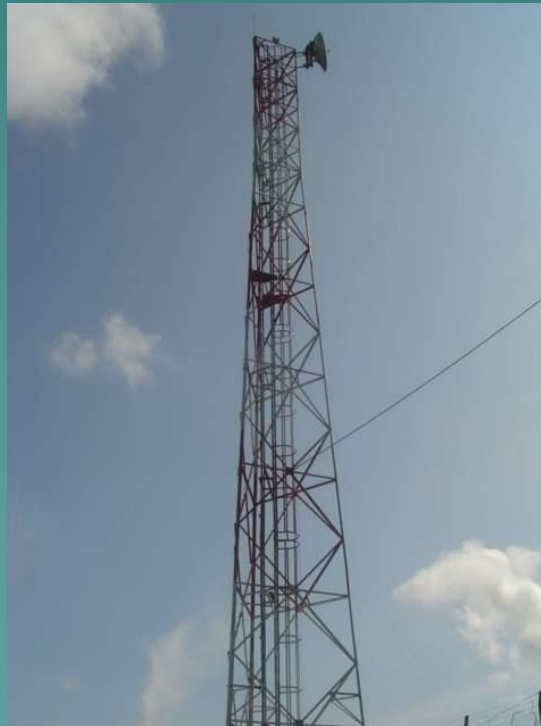
Torre de microondas
