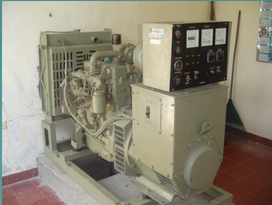
Planta de emergencia
